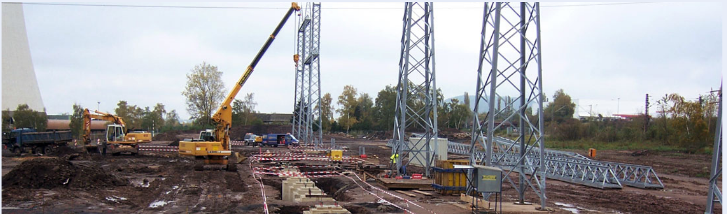
Neubau der RWE-Umspannanlage in Ens Dorf
